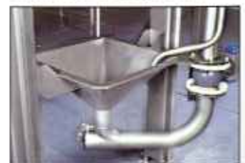
Colector con compuerta de limpieza/inspección.
